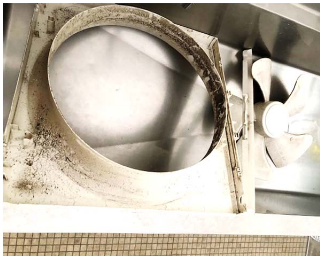
(before : 換気扇を外したらこんなに…)
